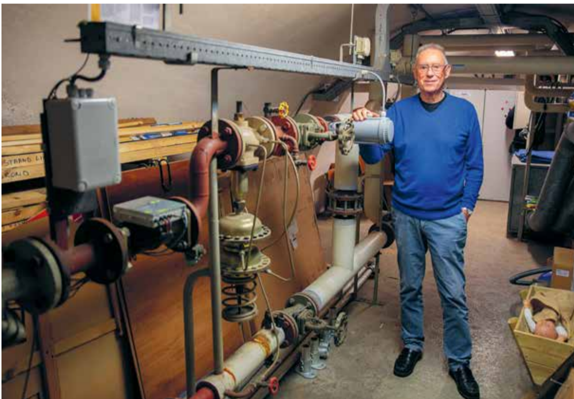
In de kelder wordt de temperatuur van het water van de stadsverwarming omlaag gebracht; te snel verhitten schaadt de Domkerk.
